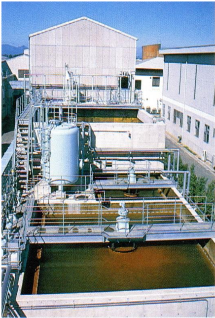
排水処理設備
